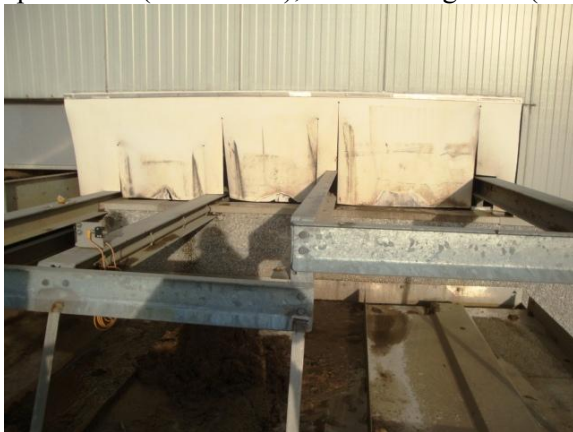
Openingen verstellen transportbanden bunkers (voorkant AO in de hoogte)
