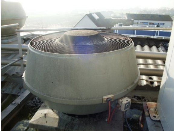
Ventilatie toevoerschudder droger (1)
