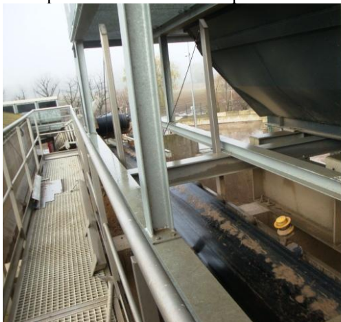
Transportband aardebunkers (4m hoogte, lengte 14 meter)
