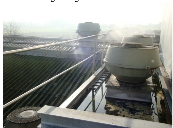
Overzicht ventilatie toevoerschudder droger
