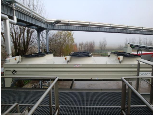
Kelvion (6 koelventilatoren) bij boogzeef
