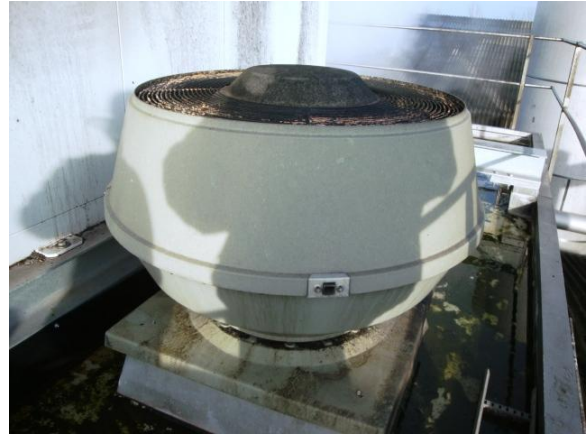
Ventilatie toevoerschudder droger (2)
