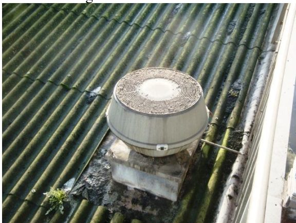
Ventilatie toevoerschudder droger (3)
