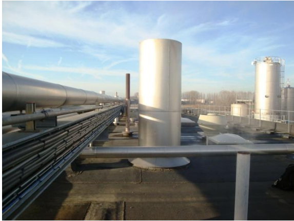
Spui stoom (smalle buis); uitlaat rookgassen (brede buis)
