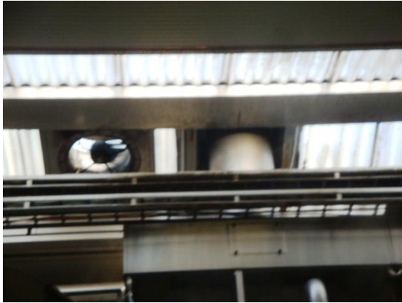
Ruimteventilatie dak productiehal
