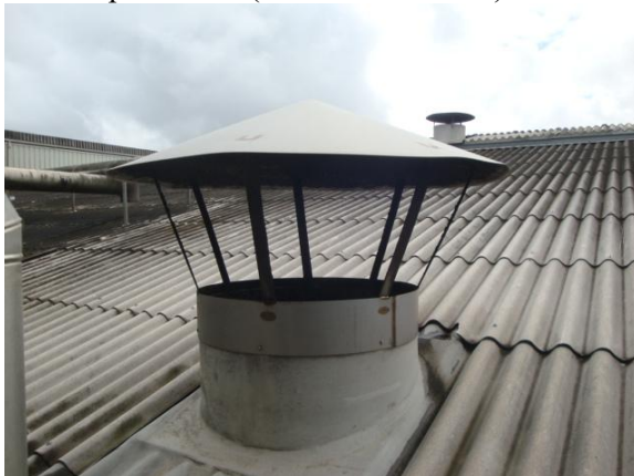
Ruimteventillatie compressoruimte (2x)
